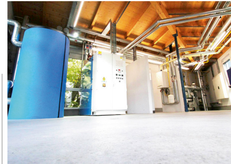
DIE HEIZZENTRALE DER STADTWERKE WAIBLINGEN.
